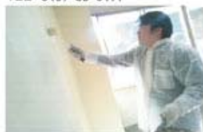
「皆様が気持ちよくご利用できるようにリフォームを実施。壁にペンキを塗る山本」
